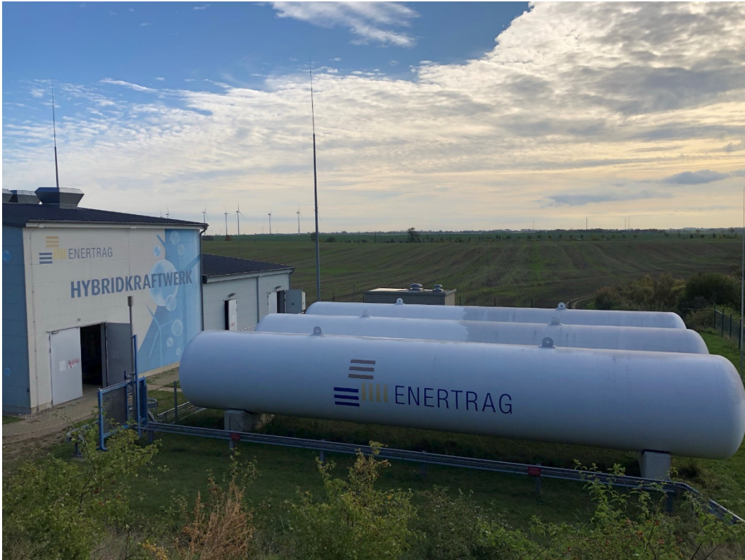
Hybridkraftwerk der ENERTRAG; © ENERTRAG
